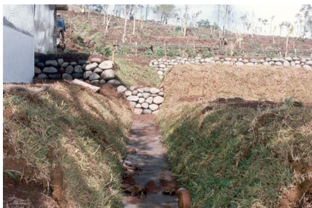
Gambar 6.8. Saluran Pembuangan Air pada Teras Bangku
